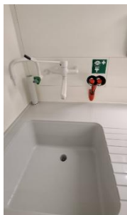
Augendusche beim Spültisch
